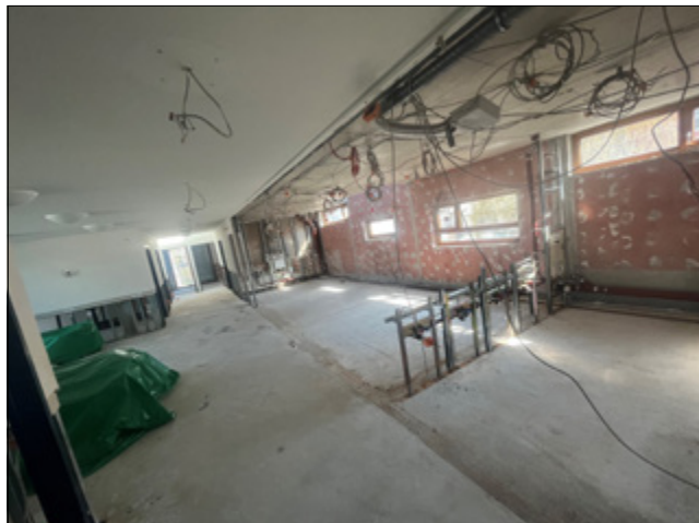
Die AWG 4 nach dem Rückbau, der wegen des immensen Wasserschadens nötig wurde.
