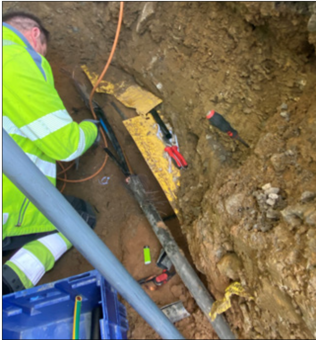
Der Kabelschaden konnte schnell repariert werden.
